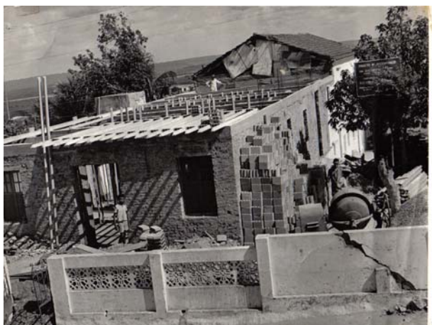
Fotografia 03 – Construção do 2º piso da União Espírita Deus, Amor e Caridade - UEDAC Fonte: Acervo da UEDAC, 2005.
